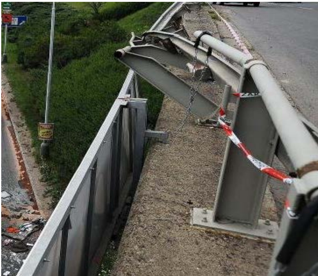
Obrázek 1 Proražené mostní svodidlo
