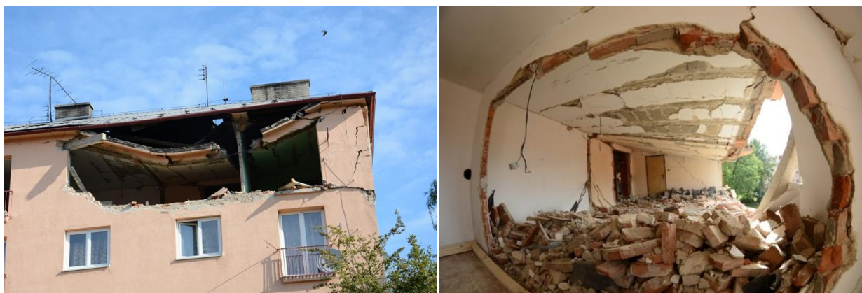
Obrázek 3 Poškozený bytový dům po výbuchu plynu v Havířově [1]
